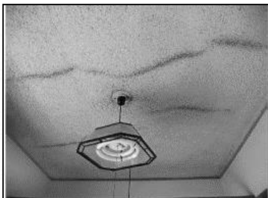
A 面的な状態はよいが、振動などによる筋状の呼吸作用の痕が見られる。
