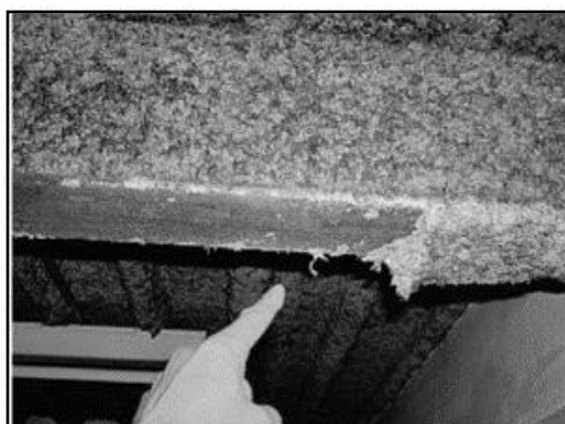
B 吹き放し工法であり、脱落箇所がある。
