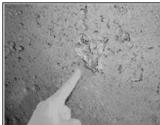
C 大きな損傷が複数箇所あり、その周辺の繊維に垂れ下がりが見られる。
